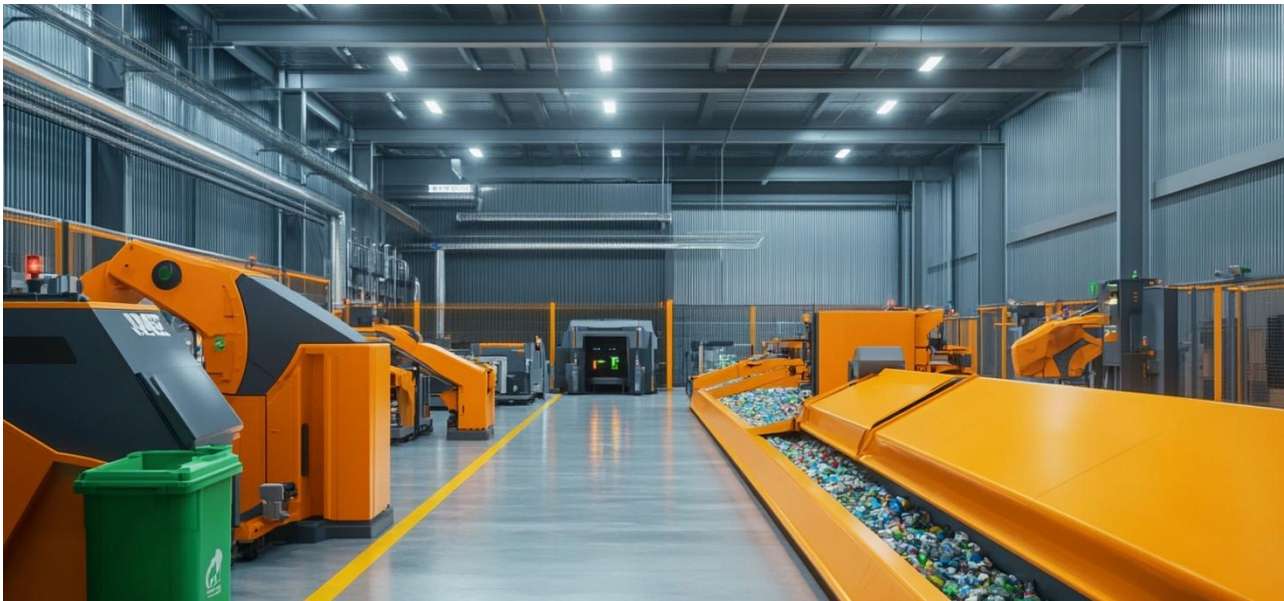
Automatisierte Sortieranlage mit Förderbändern zur Kunststofftrennung
